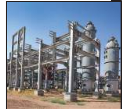
سازه‌های فلزی واحد آمونیاک صنایع پتروشیمی کرمانشاه
